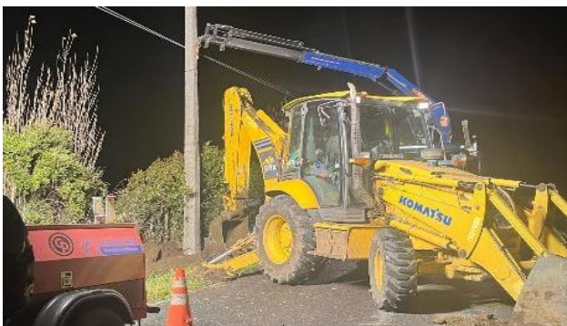
Figura 99. Caída de poste Sector Porma.
